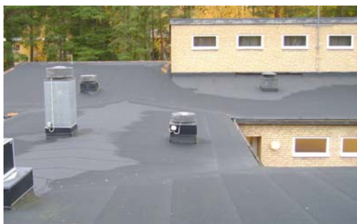
Figur 11. Taket på fritidsbyggnaden. Trots regnet är taket vått på en del ställen, vilket berodde på värmeläcket genom taket.
