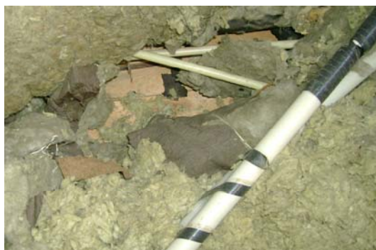
Figur 12. Skadad isolering i del av taket vid gymnastiksalen.
